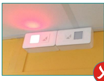
3 : Alarme non signalée
