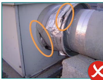
2 : Raccordements non étanches de la manchette
