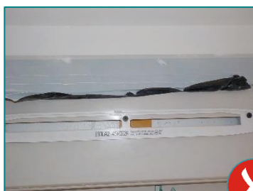
1 : Isolant obstruant complètement la mortaise
