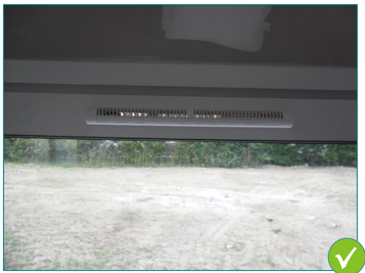
1 : Entrée d'air en bon état
