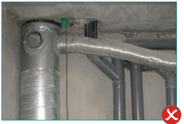
2 : Conduits souples en partie commune
