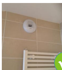
2 : Bouche d'extraction dans une salle de bain
