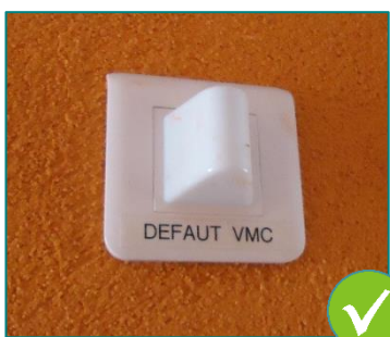
2 : Alarme correctement signalée
