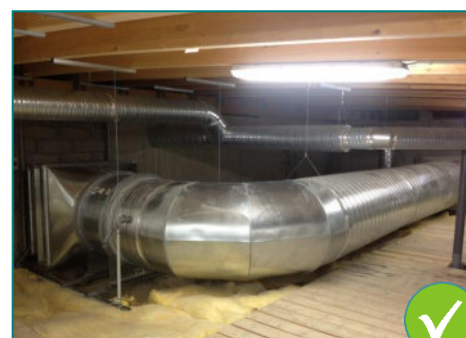
4 : Installation en conduits rigides correctement réalisée
