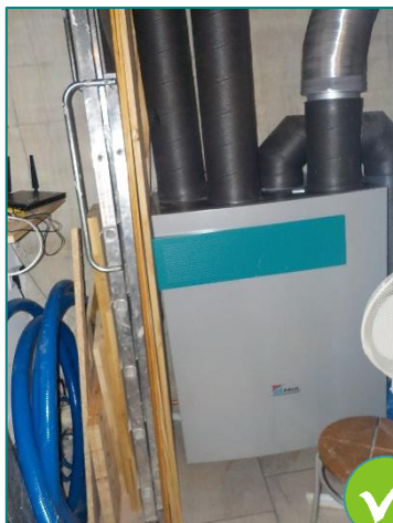
1 : Raccordements correctement réalisés sans défaut d'étanchéité visible
