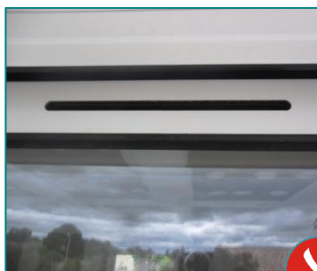
3 : Absence d'auvent extérieur
