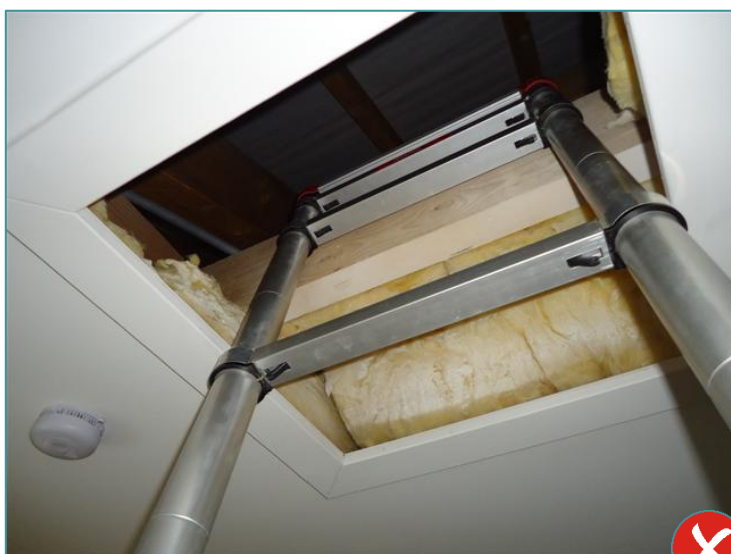
2 : Trappe d'accès encombrée et réduite
