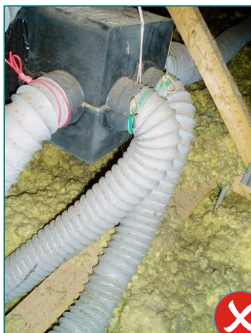
3 : Raccordements mal réalisés avec risque de débranchement
