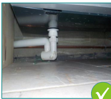
1 : Évacuation des condensats correctement réalisée
