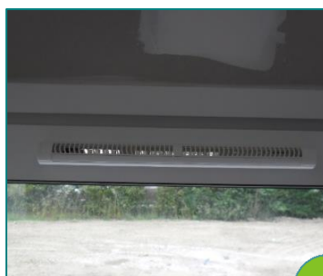
4 : Entrée d'air correctement mise en œuvre
