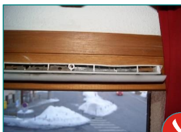
2 : Absence de mortaise derrière l'entrée d'air
